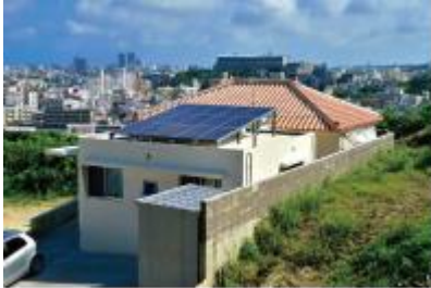
Hình 1 : 15 pano mặt trời trên nhà Y (Nguồn : Kahu, 2016)
